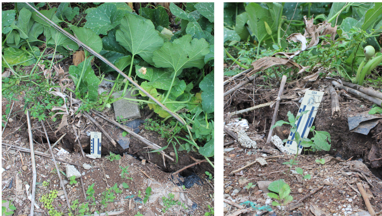
Figura 17: La grieta se dio sobre suelos compuestos principalmente de arena fina y material arcilloso.
